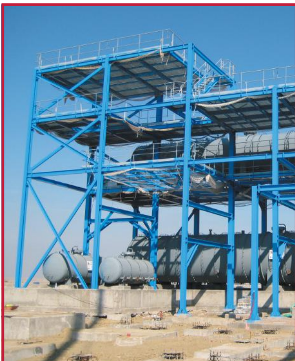
Rack de tuberías planta termosolar en Sevilla
